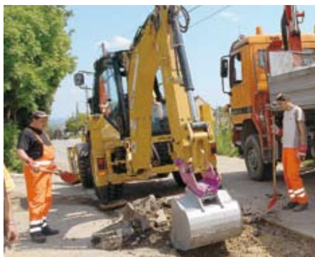
Der neue Radlader der Type Caterpillar Hydraulikbagger 428E ist bereits im Einsatz.
